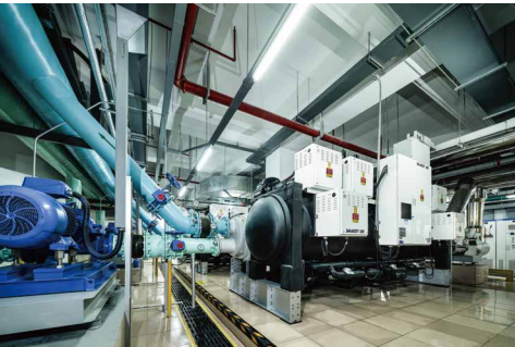
达实大厦超高效冷站
