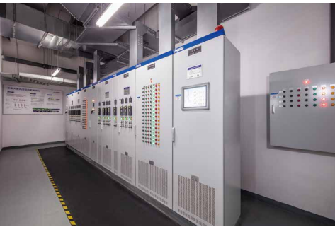
达实大厦 EMC007 中央空调节能控制柜
